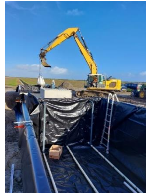
Figuur 13. Leidingwerk zuivering
