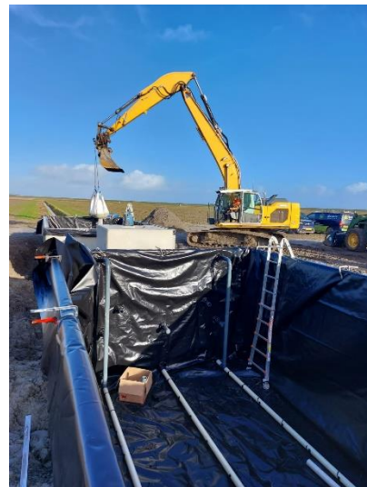
Figuur 12. Leidingwerk zuivering
