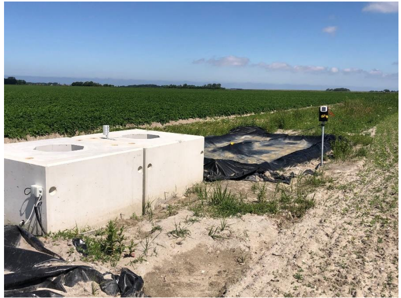
Figuur 10 Pompputten van zowel het zand-als koolfilter, locatie Hoofdweg
