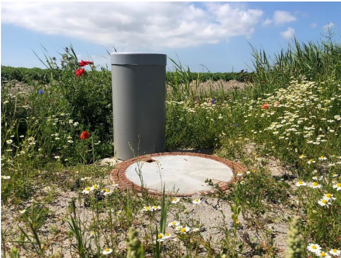
Figuur 8 Drainageput aangesloten op een van de verzamelleidingen
