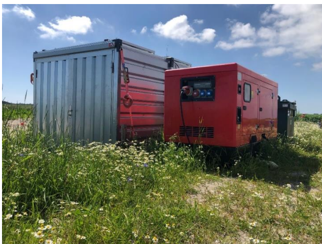
Figuur 13 Pomphuis en dieselegenerator, locatie Hoofdweg
