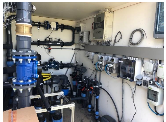
Figuur 12 Binnenkant pomphuis met benodigde aansturing en meetapparatuur voor het infiltreren en onttrekking van drie verschillende peilvakken en 2 horizontale filters, locatie Hoofdweg
