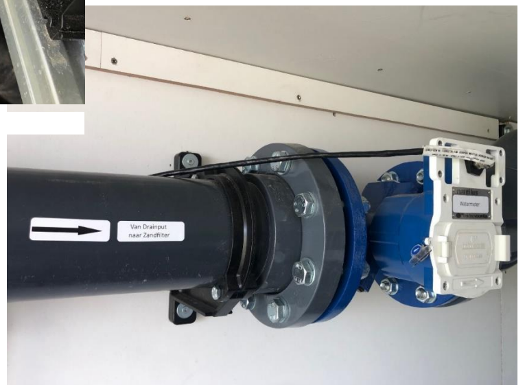
Figuur 14. Gezamenlijke watermeter van ruw drainagewater gevoed aan het zandfilter
